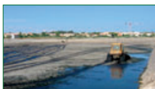
Curage du lagunage.
