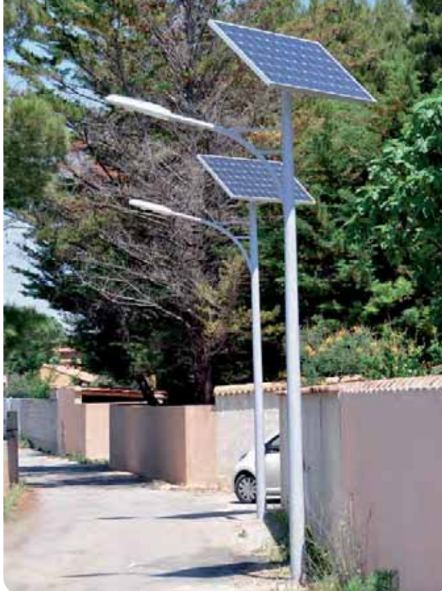
Des réverbères photovoltaïques rue de la Pyramide
