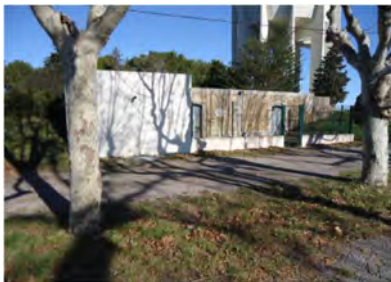
Bâches de stockage
