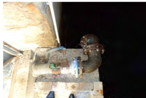
Conduite de refoulement de la pompe de secours
