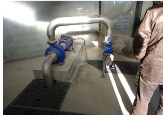
Pompe d'alimentation du château d'eau
