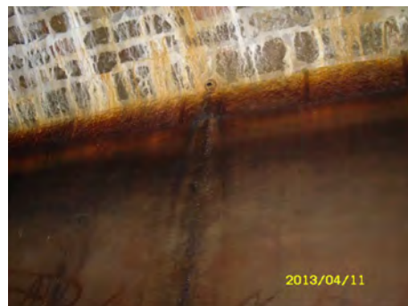
Traces rougeâtres sur les parois des cuves
