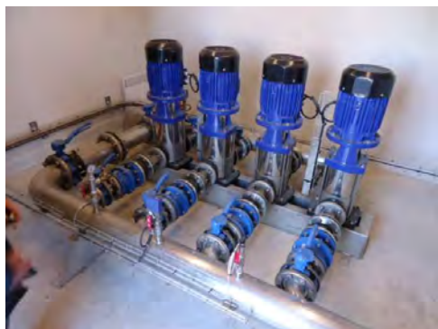
Pompes montées en parallèle
